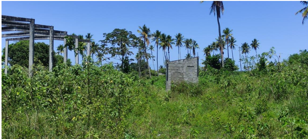
Figura 2 – Poço 02 – Abrigo do poço não concluído.
