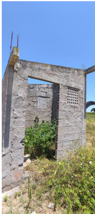
Figura 1 – Poço 01 – Abrigo do poço não concluído.
